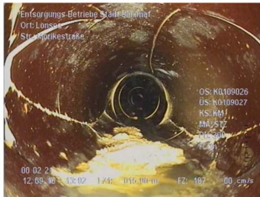
(Kanal mit Rissen)
